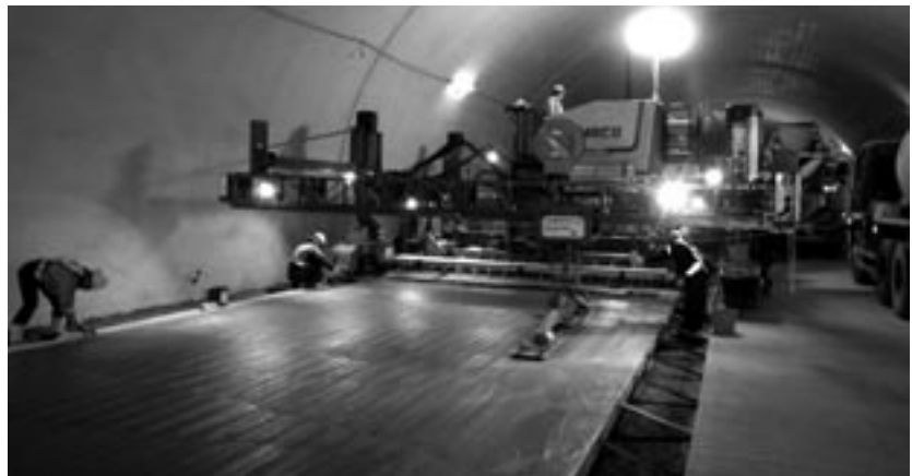
連続鉄筋コンクリート舗装・スリップフォーム工法での施工状況
