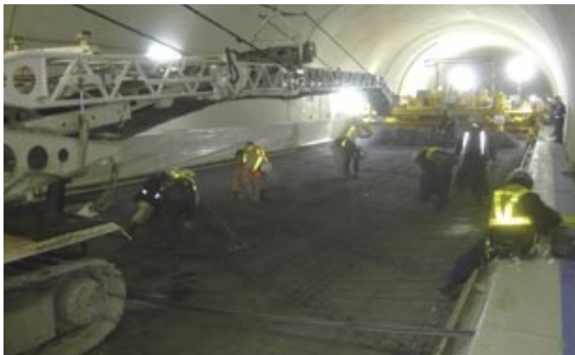
コンクリートスタッカーによるコンクリート打設状況
